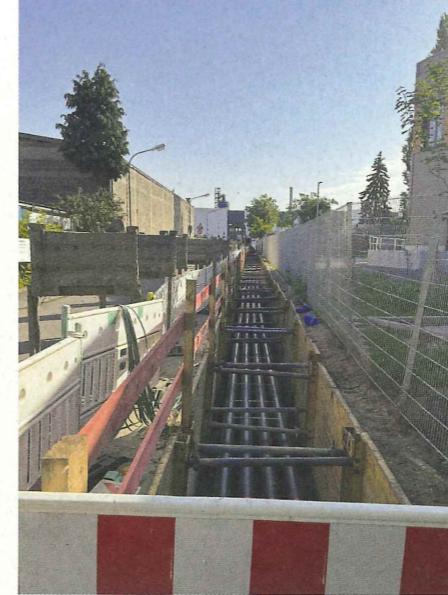
Nach dem Grabenaushub und dem Verbau erfolgte der Einbau des Leerrohrpaketes. Dieser war so ausgelegt, dass der Flüssigboden später alle Elemente nahtlos umhüllt.
